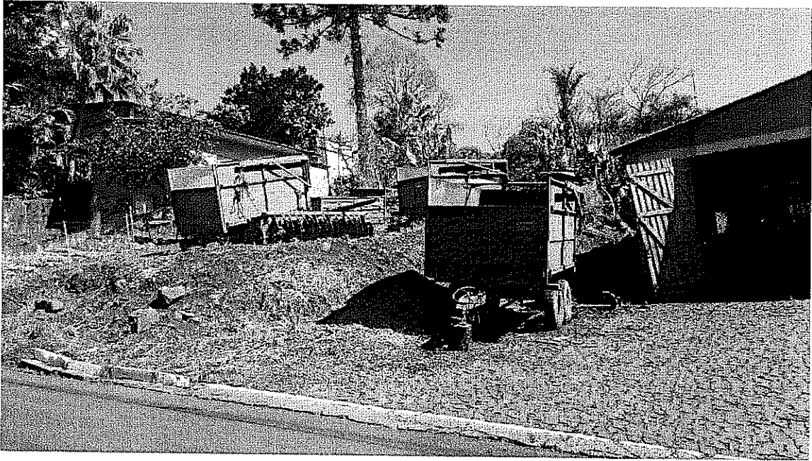
Figura 5 – Lateral esquerda desnivelada ano de 2017
